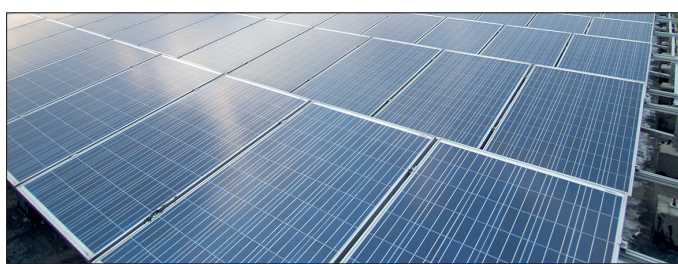
UNE CENTRALE PHOTOVOLTAÏQUE de sept mille mètres carrés a été installée dans la ZIBAY l'an dernier.
